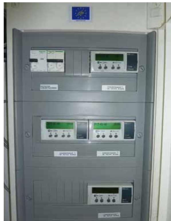
FIGURA 1. Sistema de monitorización de consumos energéticos de infraestructura TIC en el edificio PRAE de Valladolid .
